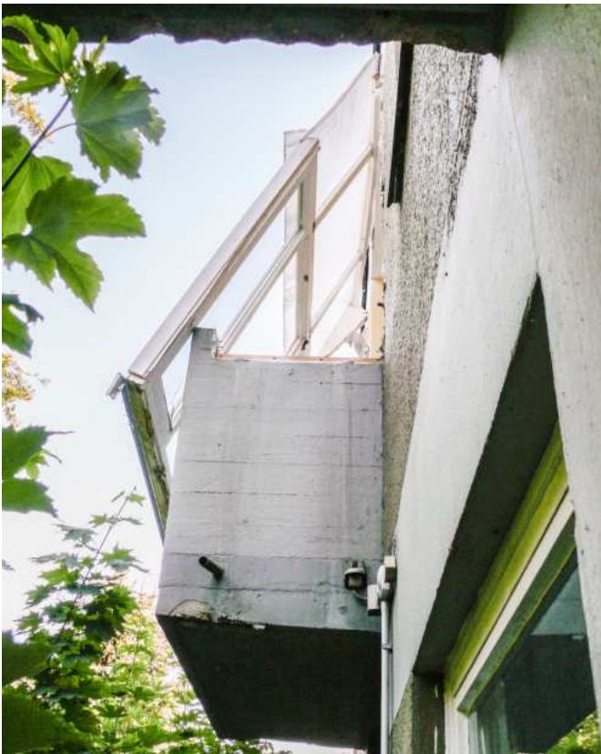
Balkonverkleidung OG NFO. Der erste Balkon vom Zentrum aus, hier von unterhalb des 2. Balkons aufgenommen.
