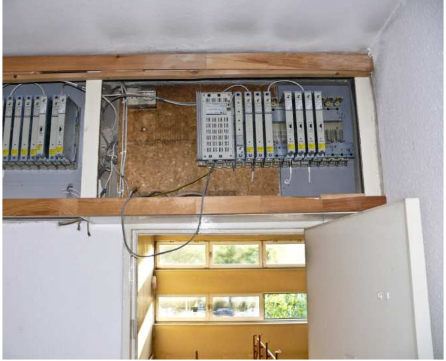
Stromkasten am Treppenhaus
