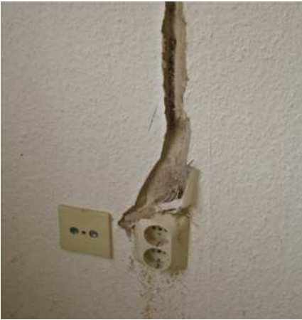
Kabel-Anschluss und Steckdose
