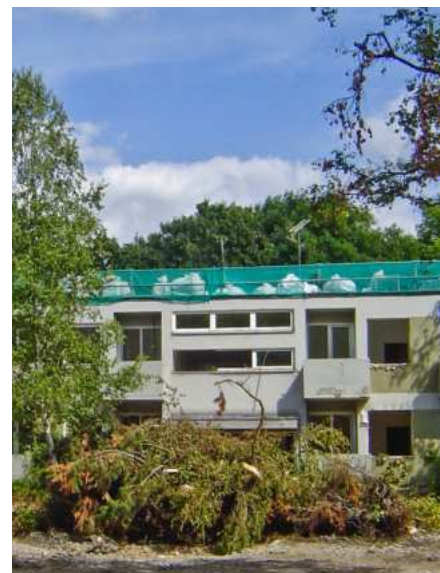
Der Nordflügel ist noch intakt. Hier ein Blick zum Eingang. Auf dem Dach werden Schadstoffe eingesammelt.
